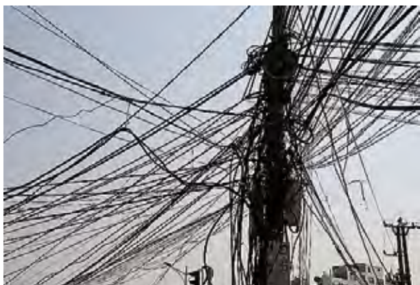
Elektriciteitskabels in Hanoi.
