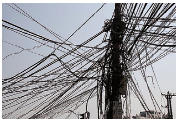
Elektriciteitskabels in Hanoi.
